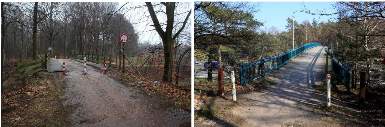
Figuur 2.8 De fiets-/voetgangersbrug over de spoorlijn (links) en over de A27 (rechts). © Foto's: E. van der Grift.
