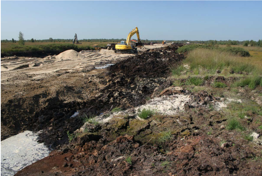
Figuur 17. In de afgelopen decennia zijn vele kilometers kade aangelegd in Nederlandse hoogveenrestanten om daarmee compartimenten te creëren waarbinnen een voor hoogveenvorming zo gunstig mogelijk waterregime gehanteerd kan worden.
