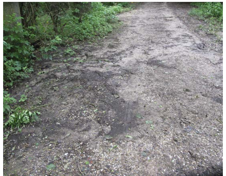
Afstroom van water en sediment over een contour-volgende weg in het Savelsbos: op het laagste punt stroomt het sediment alsnog het bos in.
